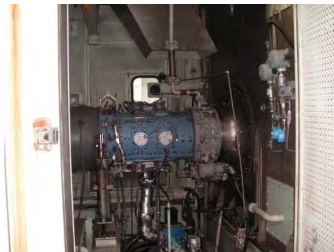
ガスタービン発電機
